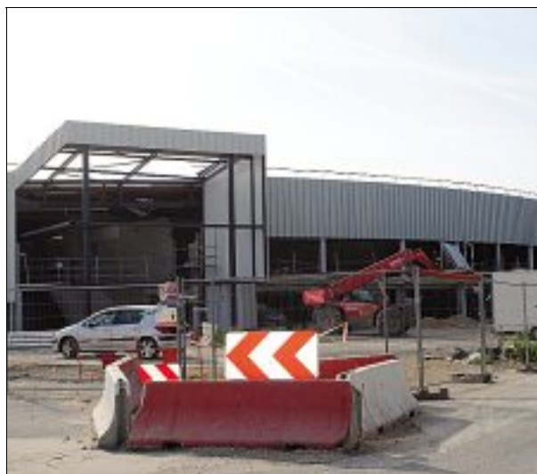
La fin des travaux de l'extension d'Intermarché est prévue pour la mi-octobre.
